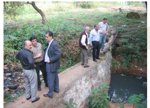
Al pie de este muro, casi en el límite de Econatura (aguas arriba), se puede notar la profunda zanja producida por la fuerza de los raudales. Los intervinientes constataron minuciosamente todo.
