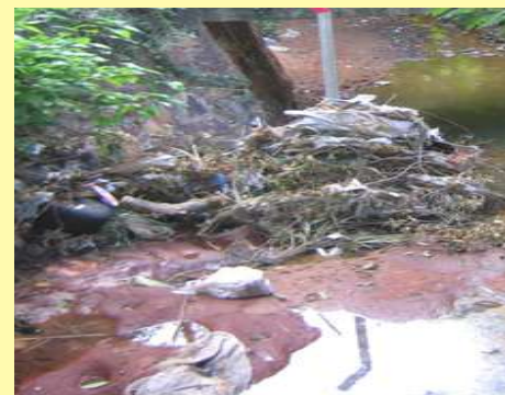
22) Vista del puente desde el cauce; el poste que se observa es un mojón que señala el lindero entre ambas propiedades y la basura acumulada sobre el mismo marca la altura de las aguas en un día de lluvia.
