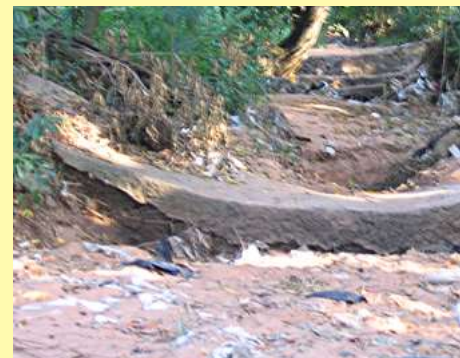
19) Vista del cauce de la cárcava y de la faja de gaviones construidos para elevar el lecho del cauce que, en algunos sectores, tenía hasta 9 metros de profundidad.
