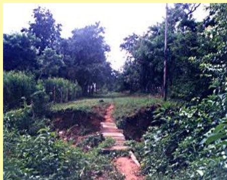
18) Precaria pasarela de madera, a través de la cual los vecinos de Valle Apu'a cruzaban la cárcava que interrumpía el paso sobre la calle Ramón I. Cardozo.
